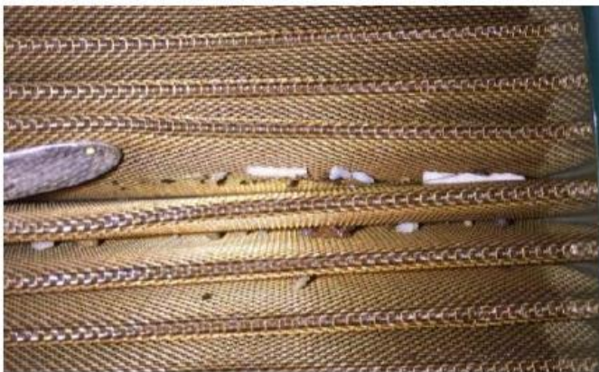
Фото 2. Вид топливного фильтра с примесями
